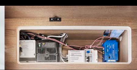
14 Vano tecnico nel 600 L
