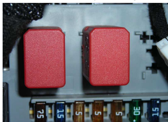
Foto 2: I relè che controllano la prese a 12 V
