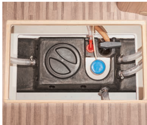
Abwassertank im beheizten Doppelboden
