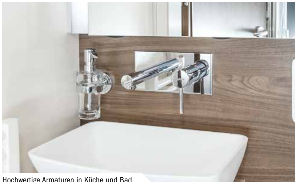
Hochwertige Armaturen in Küche und Bad
