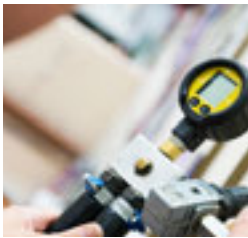
Gasol. Gasolsystemet trycktestas.
