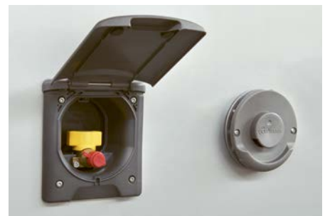
86049 Allacciamento gas sulla parete laterale
