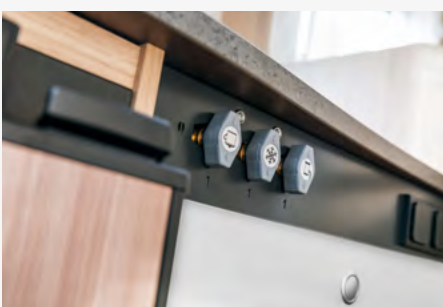
Rubinetti centrali per chiudere il gas
