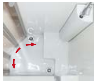
Zona doccia di grandi dimensioni
