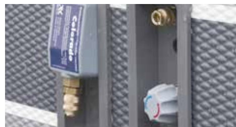
City-Wasseranschluss und Anschluss für Dusche außen.
