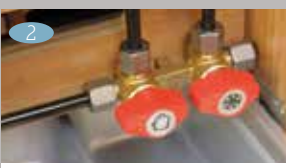
2 Répartiteur central de gaz Central gas distributor
