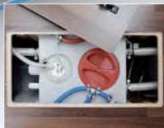
Serbatoi acqua nel doppio pavimento
