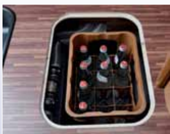
Vano nec doppio pavimento - profondo 40cm
