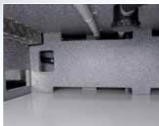
Canalizzazioni aria nel doppio pavimento
