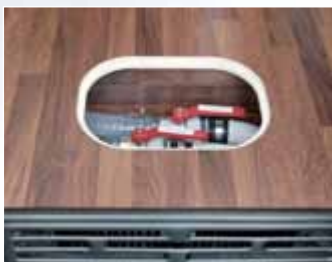
Saracinesca di scarico serbatoio
