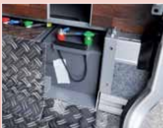
Contenitori per batterie in garage
