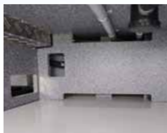
Canali per circolazione del calore nel doppio pavimento
