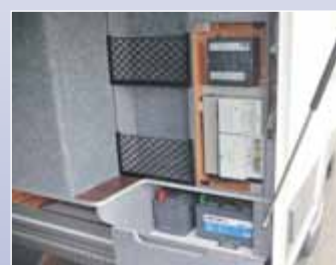
Centralina elettrica posteriore
