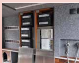
Centralina elettrica nella parte posteriore
