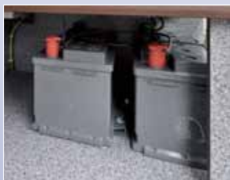
Vano per batterie nel garage posteriore
