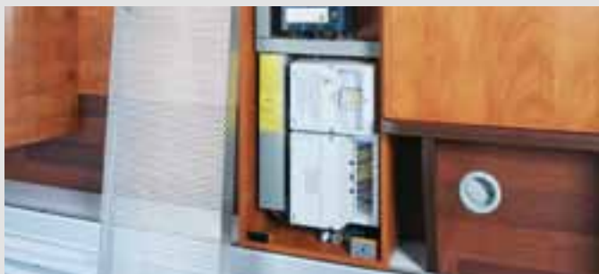
Centralina elettrica nel garage posteriore
