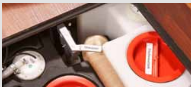
Comando dei rubinetti di scarico
