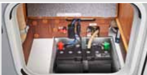
Centralina batterie nel doppio pavimento
