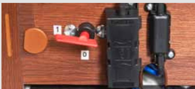
Interruttore generale batterie
