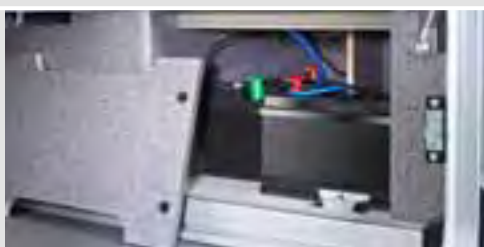
Centralina batterie nel doppio pavimento riscaldato
