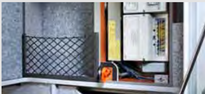
Centralina elettrica nel garage posteriore
