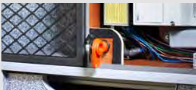
Interruttore generale batterie
