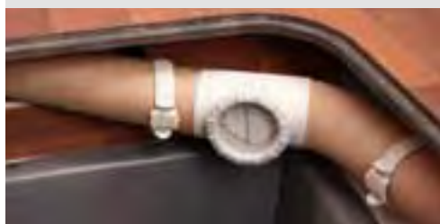
Bocchette uscita aria nel doppio pavimento
