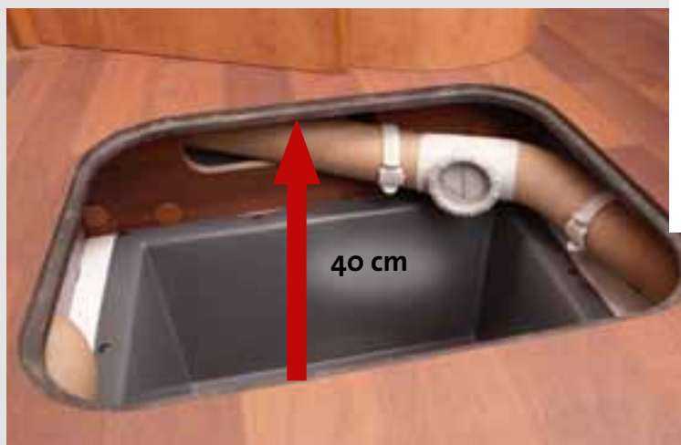
Box di stivaggio nel doppio pavimento
