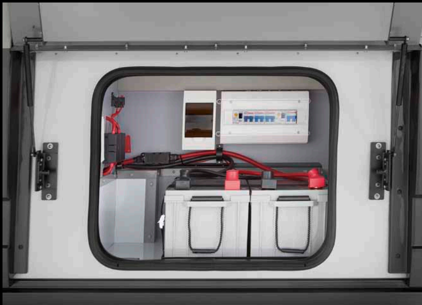
Alles auf einen Blick: Zentrale Elektroeinheit (Abb.: Elektrik-Paket 3)
