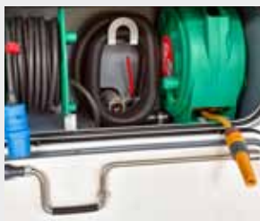
Centrale alimentazione Frankia
