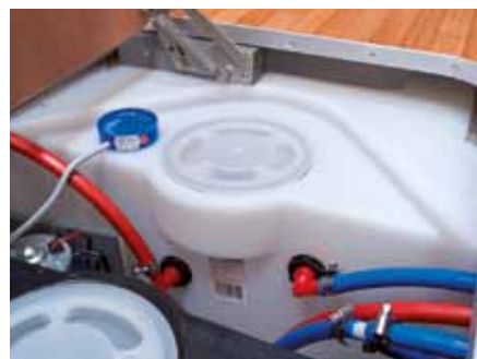
Serbatoi alloggiati nel doppio pavimento
