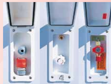
Presa acqua rete locale, doccia esterna miscelata e presa esterna gas.
