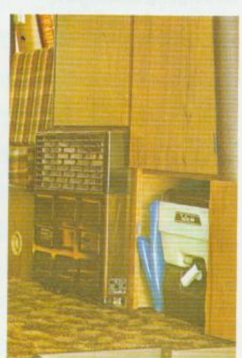
Heizung, WC, Abwasserlunge
