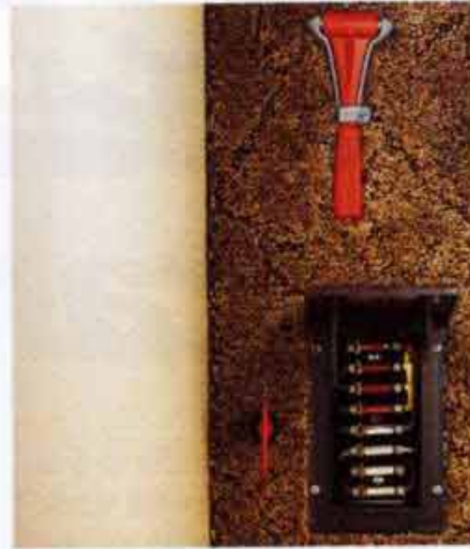
Scatola dei fusibili.
