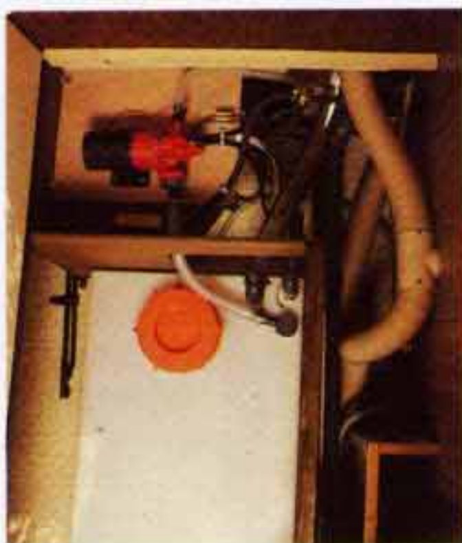
Tubi dell'acqua isolati e disposti all'interno.
