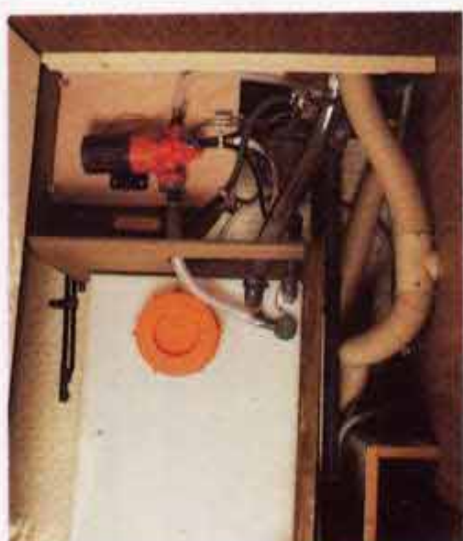
Tubi dell'acqua isolati e disposti all'interno.
