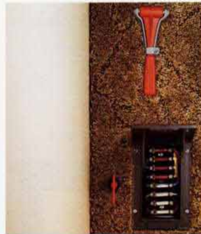
Scatola dei fusibili.
