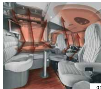
Zona abitativa: Bocchetta aria calda della finestra e sotto la dinette a L
