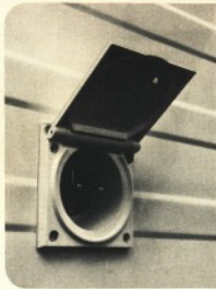
Außensteckdose mit innen liegenden Sicherungen für 220 V.
