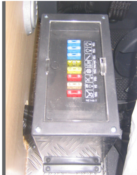
PORTAFUSIBILI FISSATO AL PAVIMENTO
