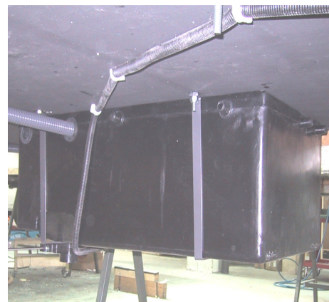
SERBATOIO ACQUE SCURE
