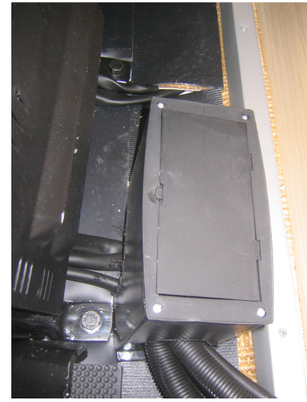
PORTAFUSIBILI FISSATO AL PAVIMENTO
