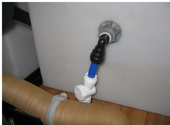
VALVOLA SCARICO PARZIALE SERBATOIO
