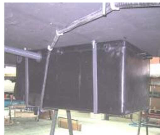
SERBATOIO ACQUE SCURE
