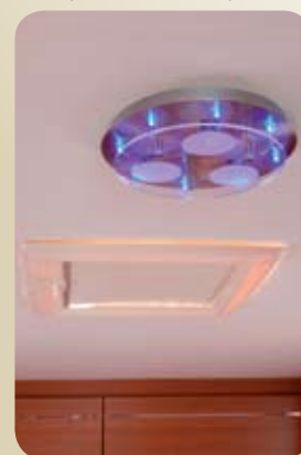
Led lighting / Deckenbeleuchtung mit LED / Plafoniera con illuminazione a LED
