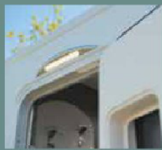
Eclairage extérieur à leds / External LED lighting / LED-Außenbeleuchtung
