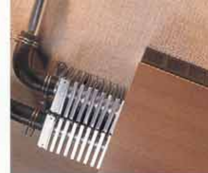
Kollektor der Warmwasser-Zentralheizung
