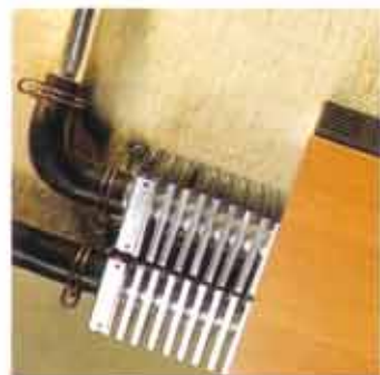
Kollektor der Warmwasser-Zentralheizung
