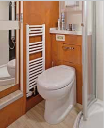
Keramiktoilette und Handtuch-Heizkörper
