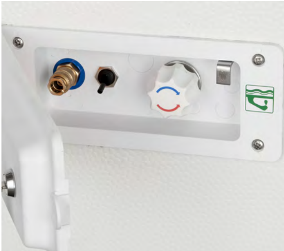
Aussenanschluss für Dusche
