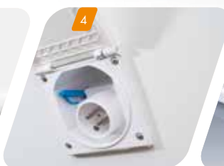
Prise extérieure (P17) Toma exterior
