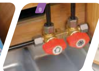
Répartiteur central de gaz Distribución del gas
