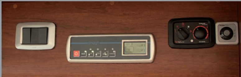
Controllo centralina con schermo LCD. Rilevamento di temperatura interna ed esterna.
