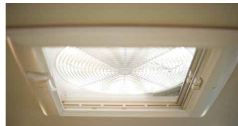
Takfönster i Omniventversion vagnen
