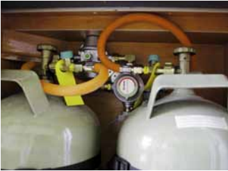
Gasregler-Anlage Truma DuoComfort Défendeur Truma DuoComfort avec inverseur automatique
