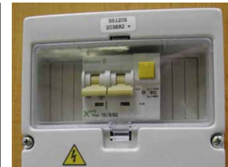
In Luxus-Ausstattung enthalten: 230-V-Anlage mit CEE-Eingangssteckdose und 13-A-Sicherungsautomat (Zwangsoption bei Batterie mit Trennrelais und Ladegerät). Gewicht: 2.2 kg
