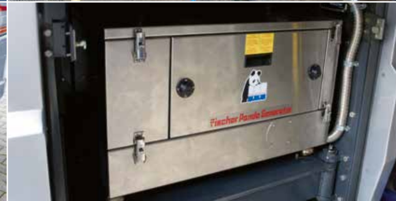
Generator, doppelt schalldicht gekapselt, vollautomatisch gesteuert durch Brain-Pilot, Abgas- und Kühlluftführung über Dach.
